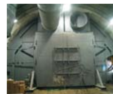
坑口に設けられた防音扉
