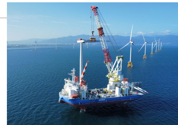
石狩湾新港洋上風力発電所
