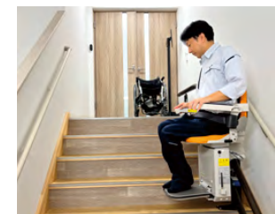
車いす利用者のための現場事務所昇降機
