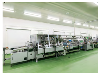
キョーリン製薬グループ工場(株) 高岡工場 包装設備(富山県高岡市)
