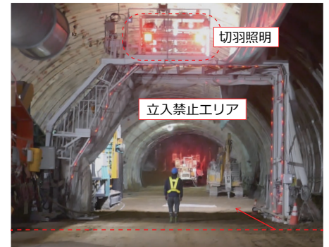
警告照明システム
