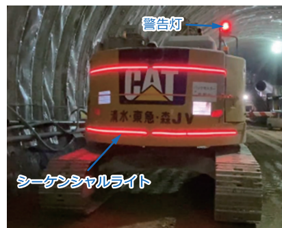
警告灯・シーケンシャルライト点灯
