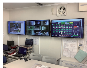
統合管理モニタ（事務所）
