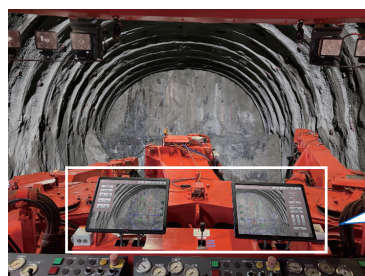
モニタ設置状況
