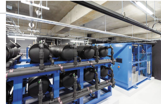
建物付帯型水素エネルギー利用システム 「Hydro Q-BiC」
